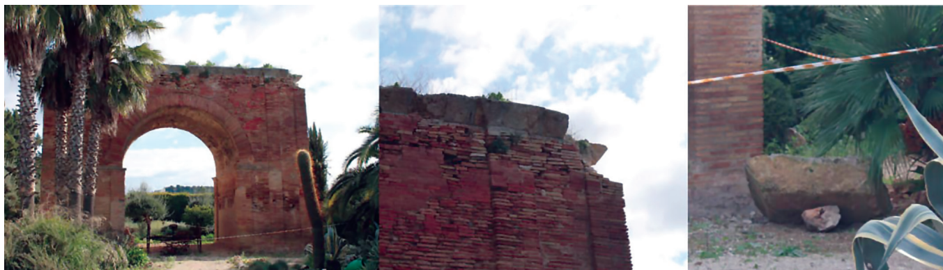
Arco onorario deteriorato dal cedimento di parte del cornicione, con particolari della parte danneggiata e del masso a terra. (Foto Specchio, gennaio 2022)
